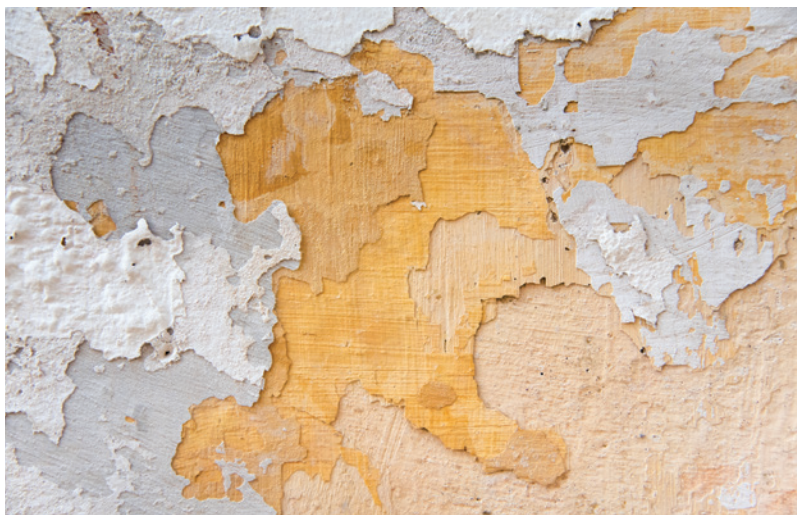
Detalhe das camadas de pintura das paredes e dos muros nas fachadas do centro histórico de Ouro Preto. Fonte: Fernando Cardoso, 2025.
